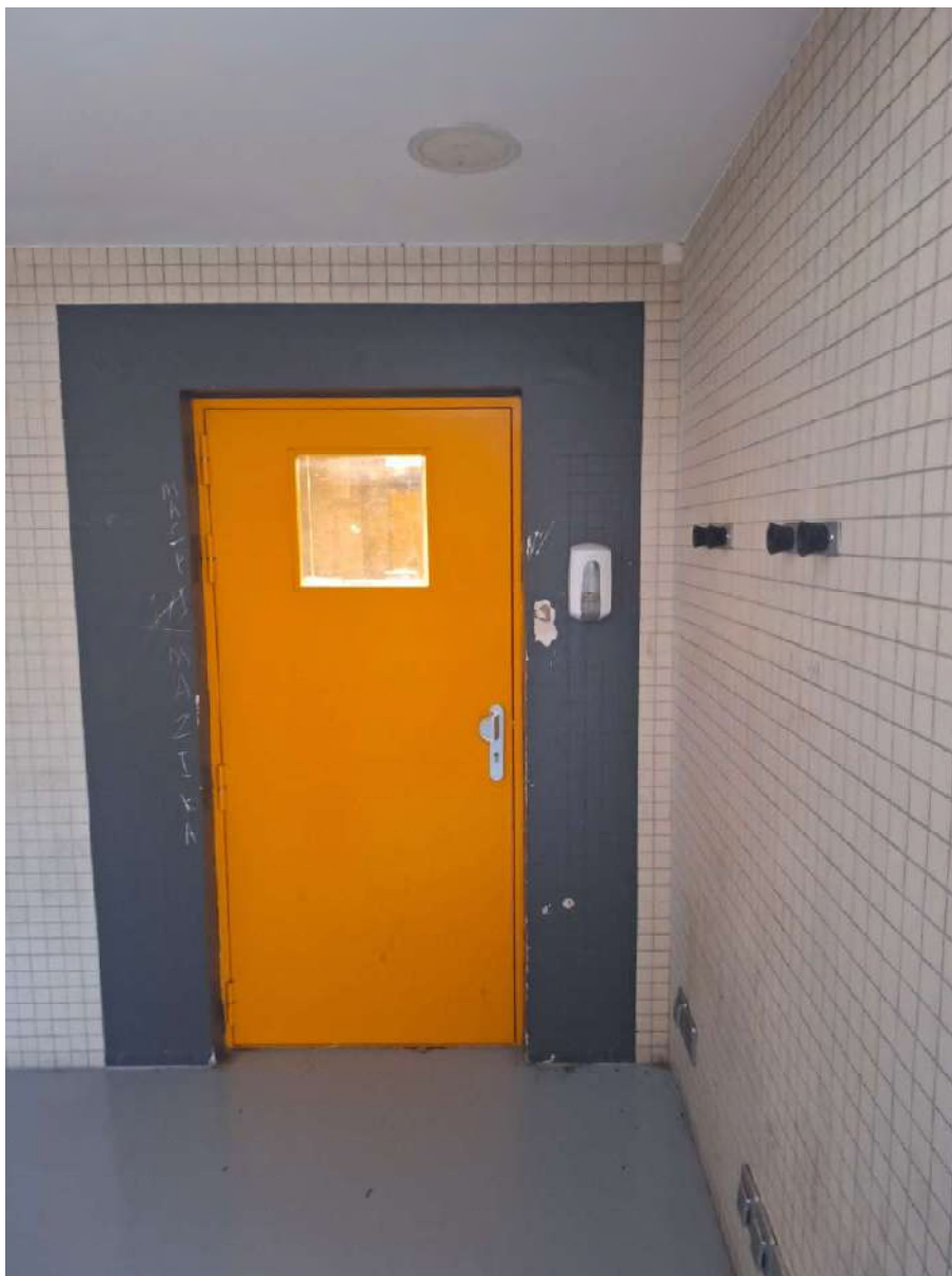
(Vue de la porte donnant sur le poste)
