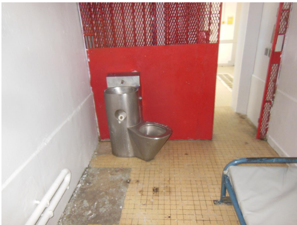
Autre angle de vue de la même cellule disciplinaire (carrelage impacté avec traces de brûlures et chape de ciment pour réparer une partie détériorée)
