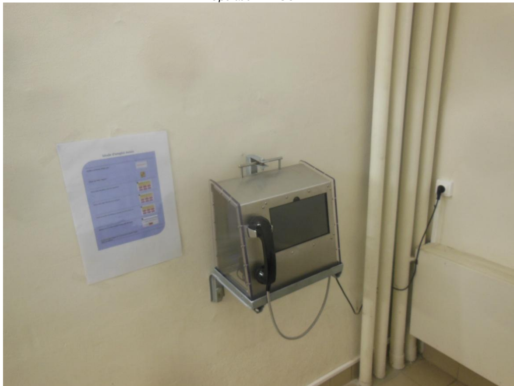
Espace confidentiel permettant aux détenus d'appeler en extérieur avec système de visionnage réciproque des interlocuteurs.
