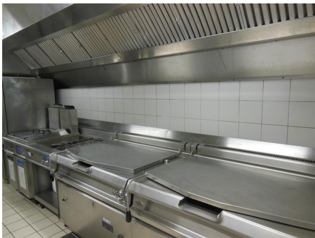
Cuisine collective de l'établissement (équipements de cuisson)
